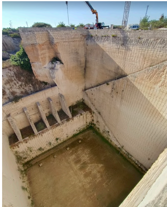
Fig. 10. Estado actual del hueco
