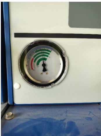
Manómetro indicador del nivel del Gas SF 6
