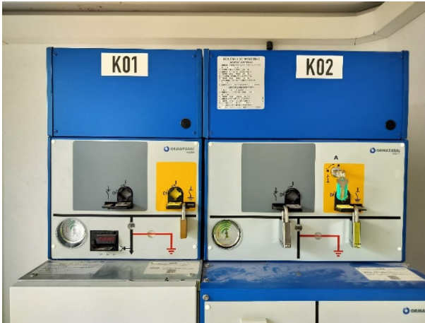
Cubas de gas instaladas en un parque del mismo promotor.
