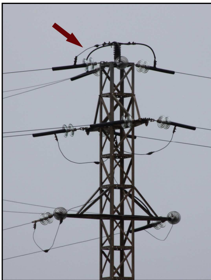
Figura 7: Torreta T13 de la línia Tirant-Lluriac. S'aprecia la manca d'aïllament d'un dels ponts superiors.
