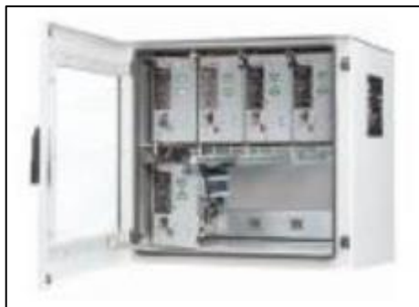
Imagen 13. Alojamiento del accionamiento de los seccionadores
