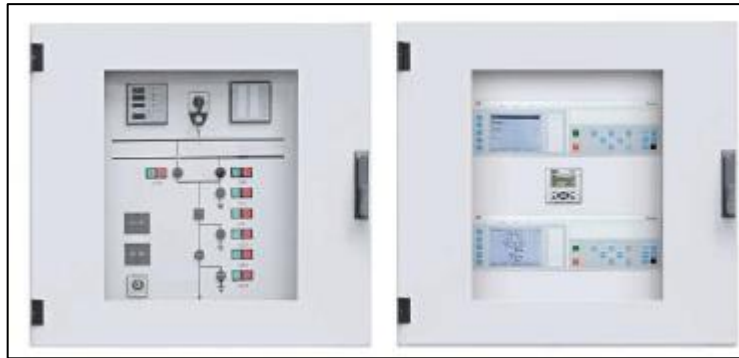
Imagen 26. Cubículos locales de control
