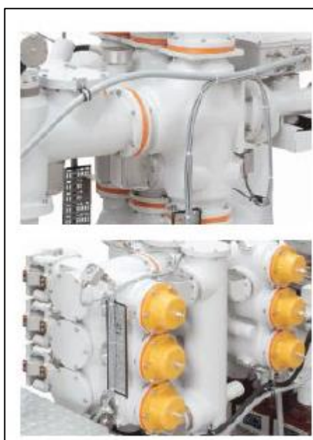
Imagen 15. Detalle de la ubicación de los seccionadores
