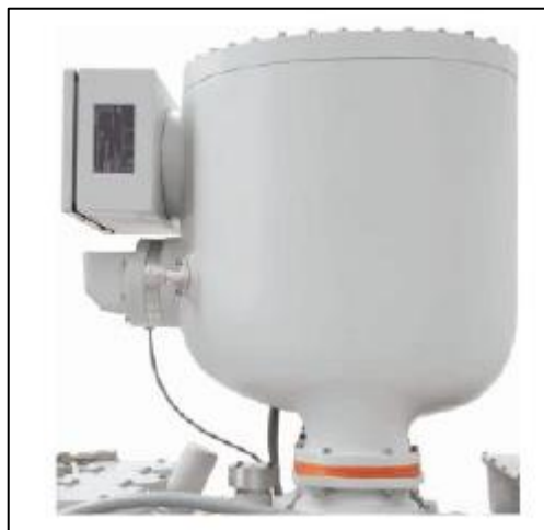
Imagen 23. Vista exterior del transformador de tensión
