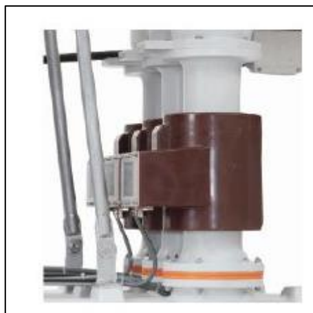
Imagen 21. Vista exterior del transformador de intensidad
