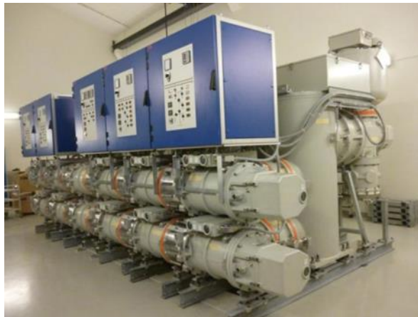
Imagen. Interruptor tipo GIS 66 KV
