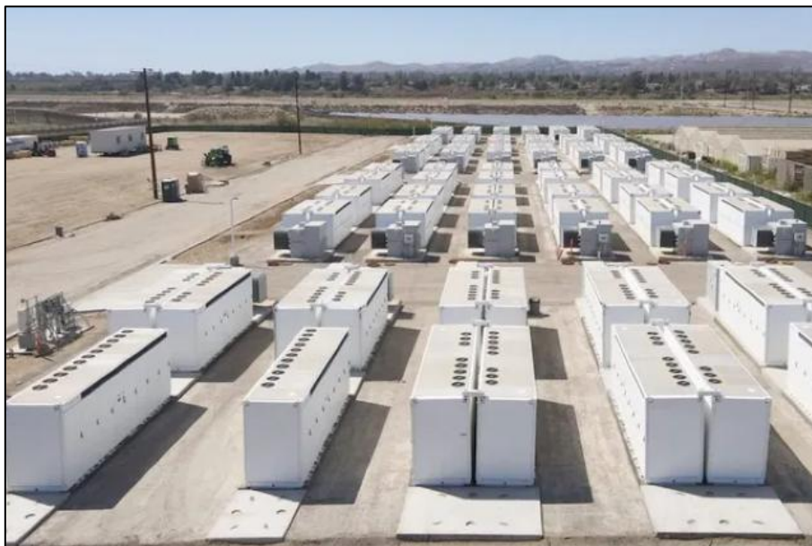
ILUSTRACIÓN 6 EJEMPLO DE SISTEMA DE BATERÍAS
