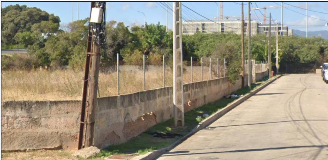
ILUSTRACIÓN 17 ESTADO DEL CERRAMIENTO DE LA PARCELA
