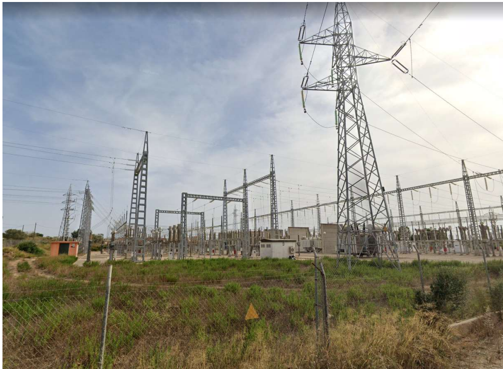
Figura 41. Vista actual de la SE con pòrtico existente
