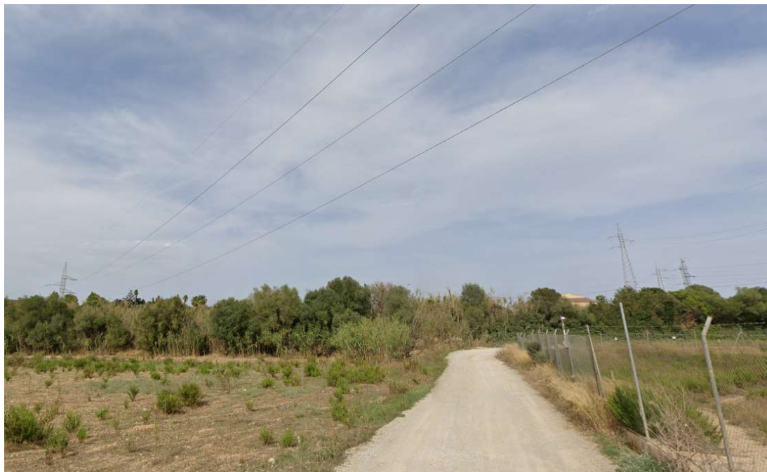
Figura 44. Detalle conductores existentes a su llegada a SE Bessons
