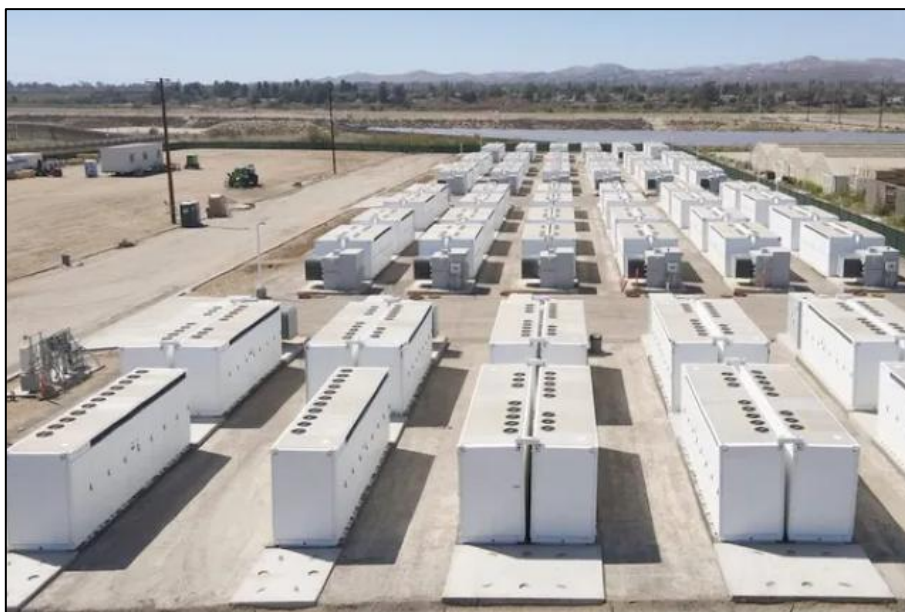
ILUSTRACIÓN 5 EJEMPLO DE SISTEMA DE BATERÍAS
