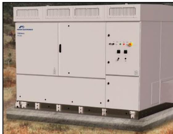
Imagen 15: Detalle del inversor.
