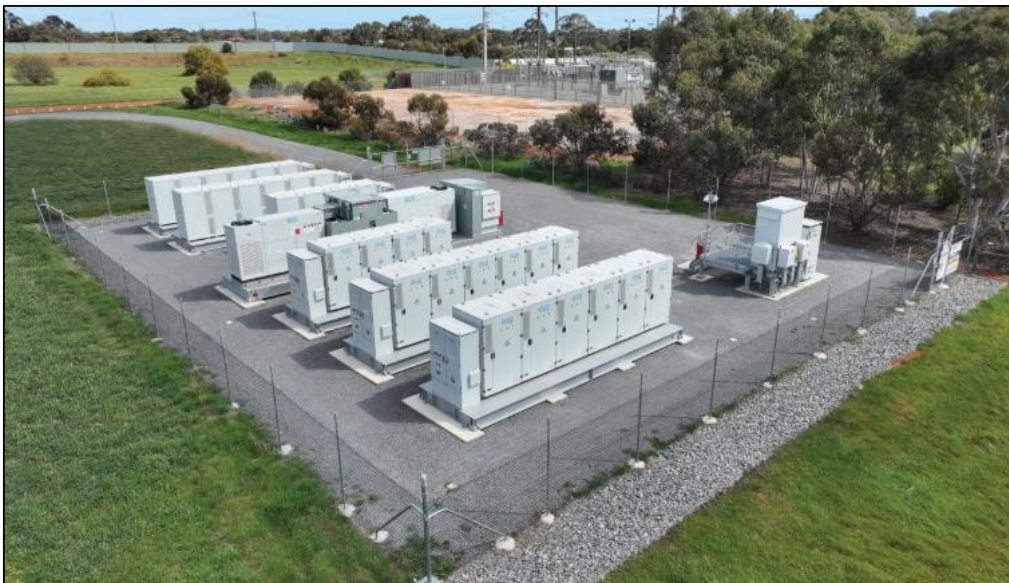
ILUSTRACIÓN 6 EJEMPLO DE SISTEMA DE BATERÍAS
