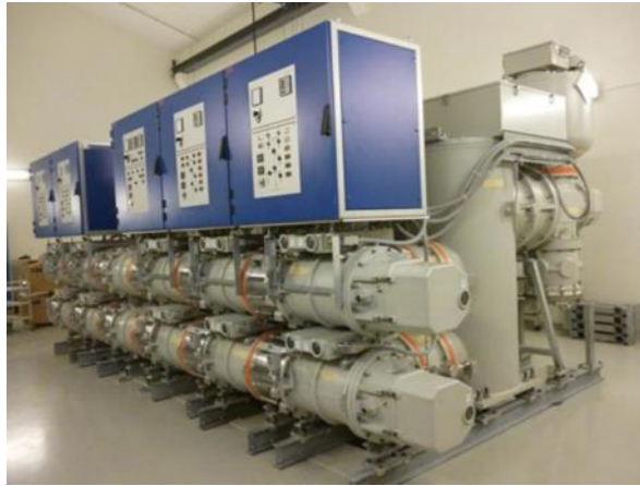
Imagen. Interruptor tipo GIS 66 KV
