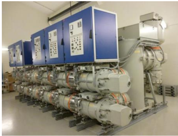
Imagen. Interruptor tipo GIS 66 KV
