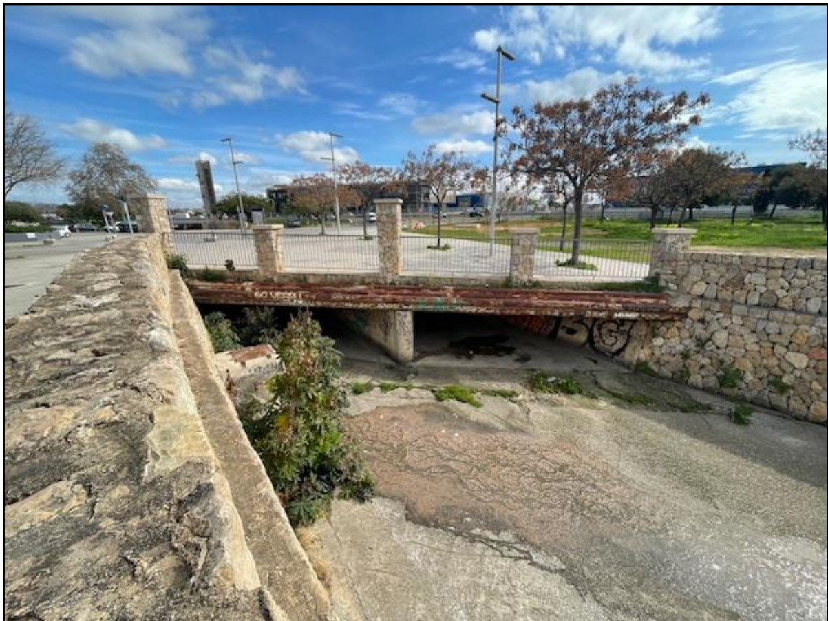
Imagen 8: Estado actual del puente que cruza el torrente de Na Barbara.
