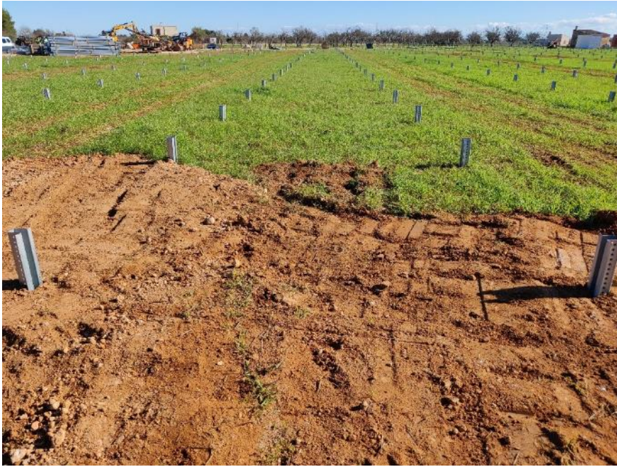
Hincado de soportes de acero galvanizado en el parque solar fotovoltaico Can Fuster (Santa Maria del Camí).
