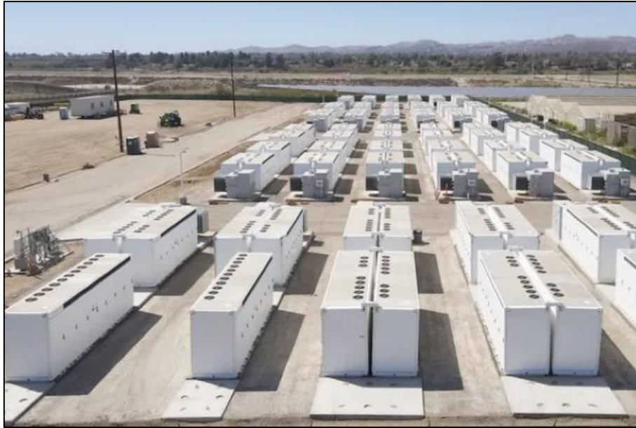
ILUSTRACIÓN 6 EJEMPLO DE SISTEMA DE BATERÍAS
