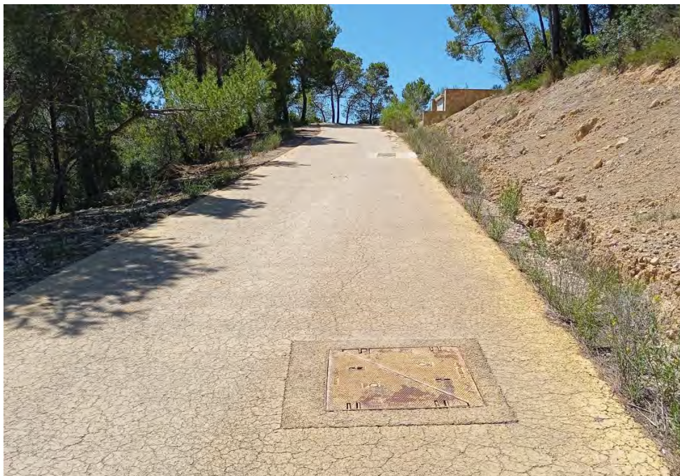
Foto2. Carrer Cala d'Egos, por donde pasará la nueva LSMT y CT 50716 de fondo.
