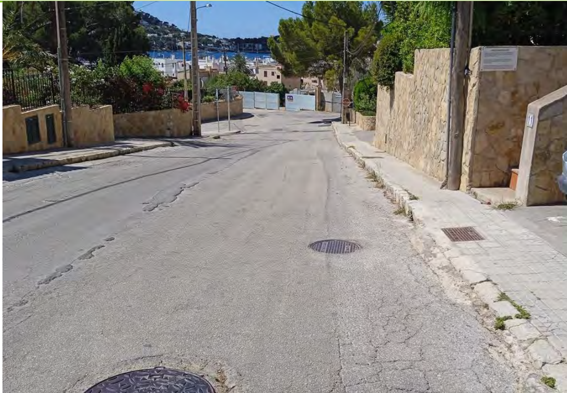
Foto11. Carrer Aldea Blanca, por donde pasará la nueva LSMT
